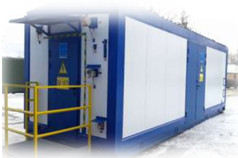
Блок-контейнеры электропитания БК (УГП)
