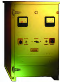
VAKZ rectifier units
