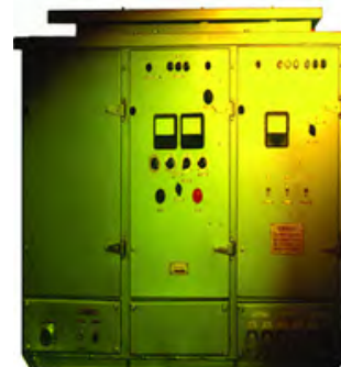
VAK rectifier units
