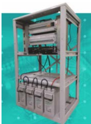
Электропитающие устройства (ЭПУ)
